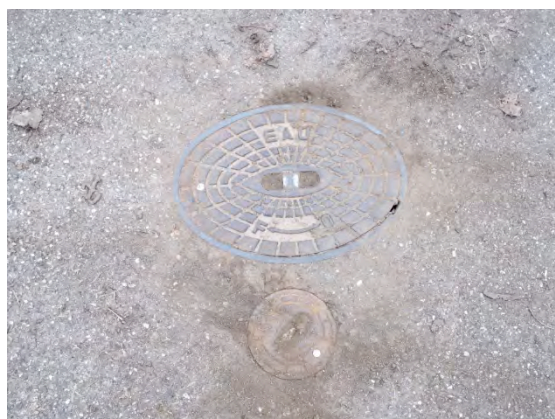
Photo de la bouche d'incendie
